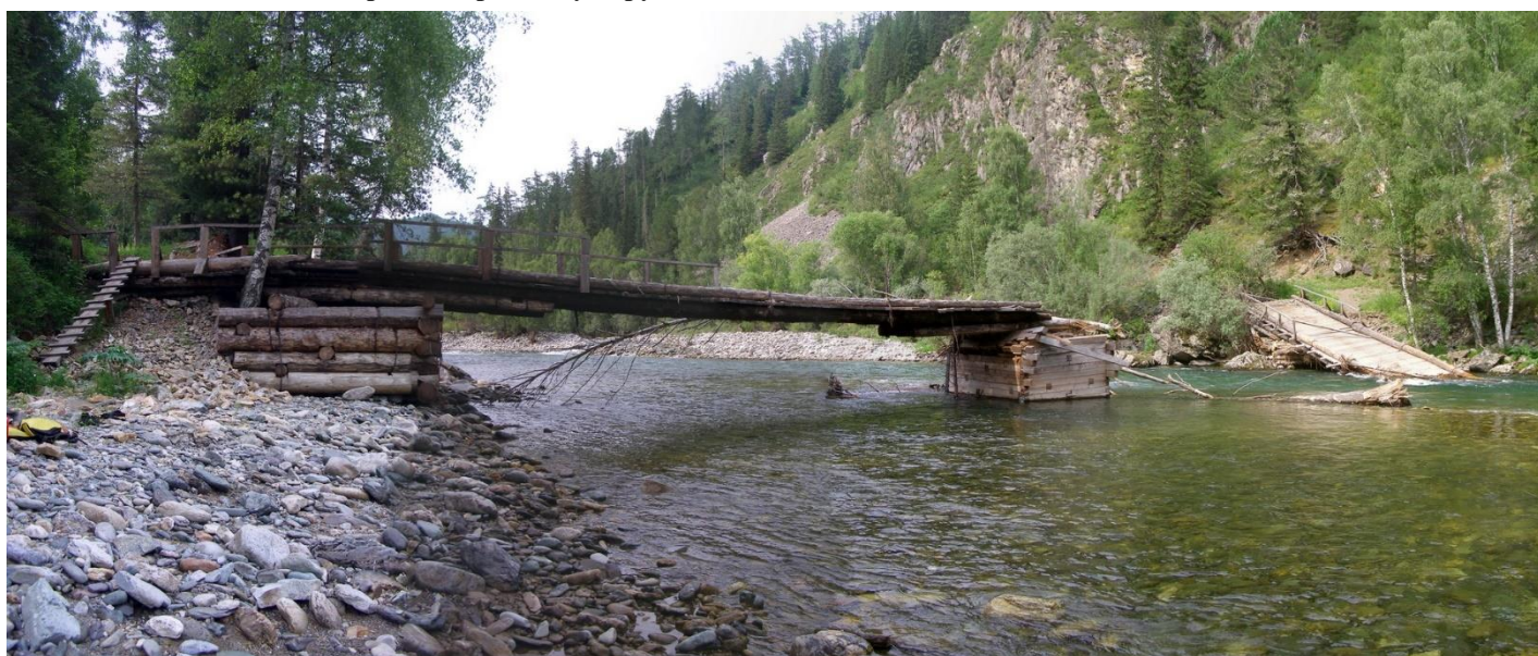
Фото 41. Полуразрушенный Ипатовский мост
