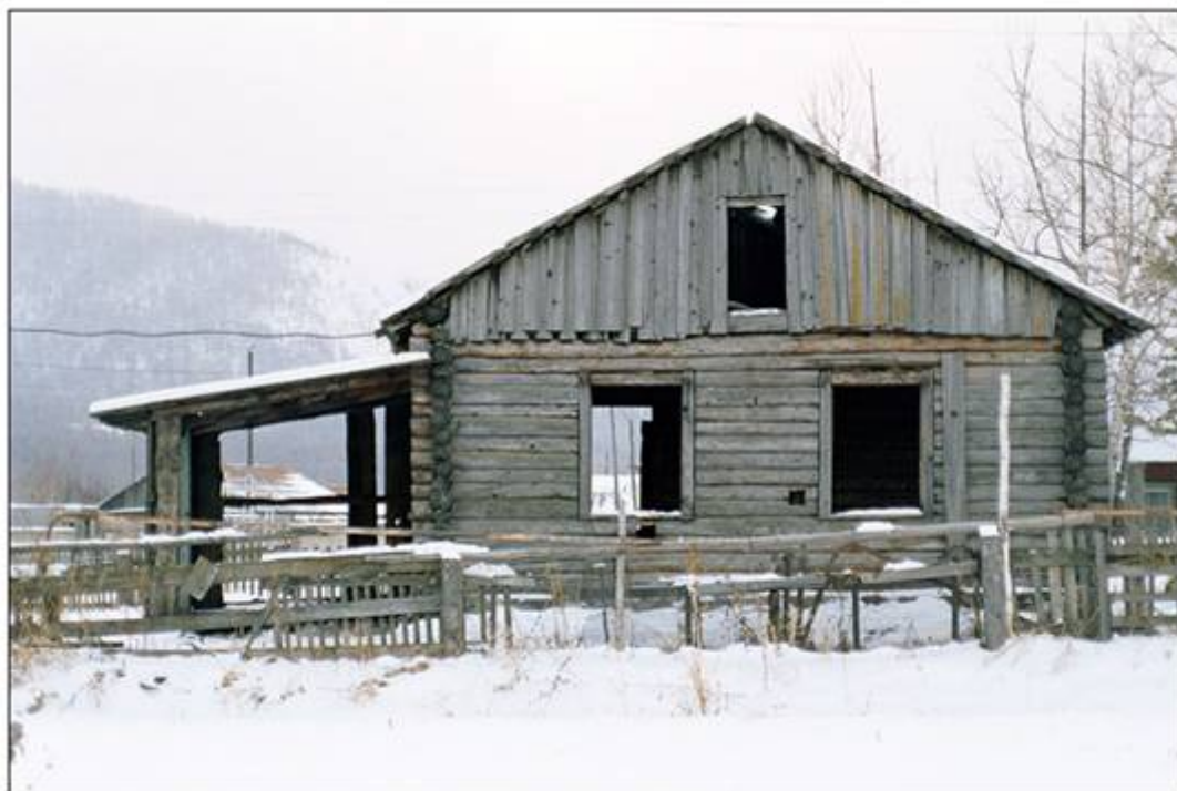
Фото 8. Зброшeнный дом в пос. Ефрепкино
